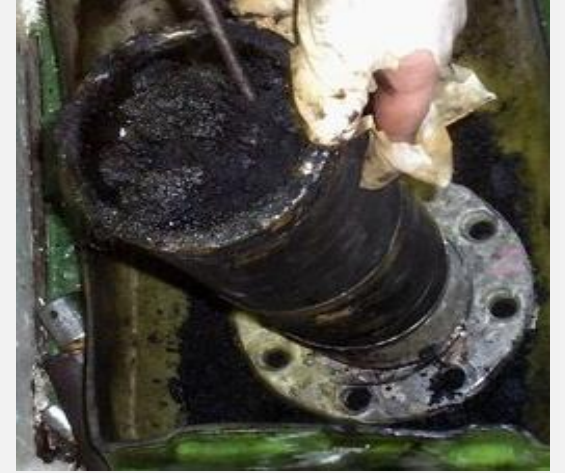
Aşırı çamur oluşumu
