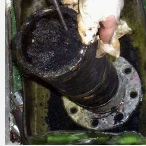
Aşırı çamur oluşumu nedeniyle arıtıcının tıkanması
